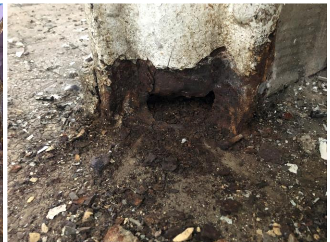
Foto Nr. 23 Kolonnu balsta mezgli virs grīdas caurkorodējuši.
