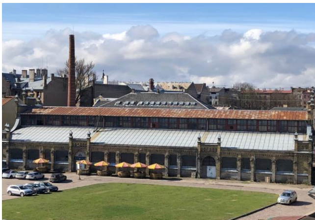
Foto Nr. 38 Virsgaismas zonas jumta segums korodējis.
