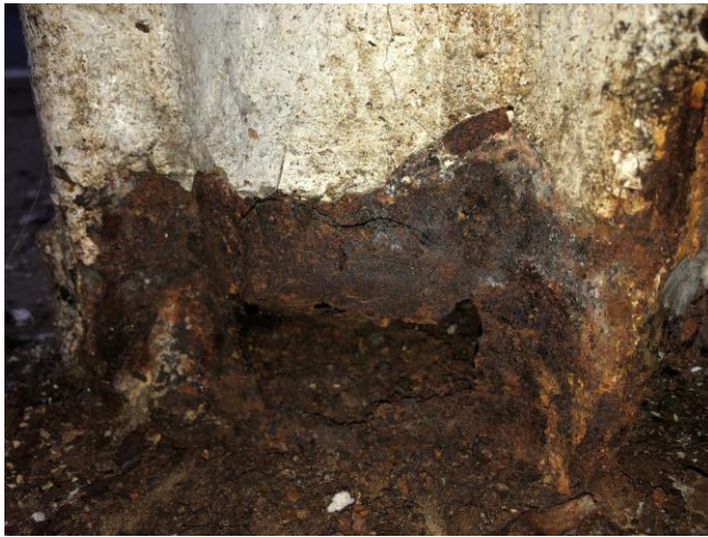
Foto Nr. 24 Kolonnu balsta mezgli virs grīdas caurkorodējuši.
