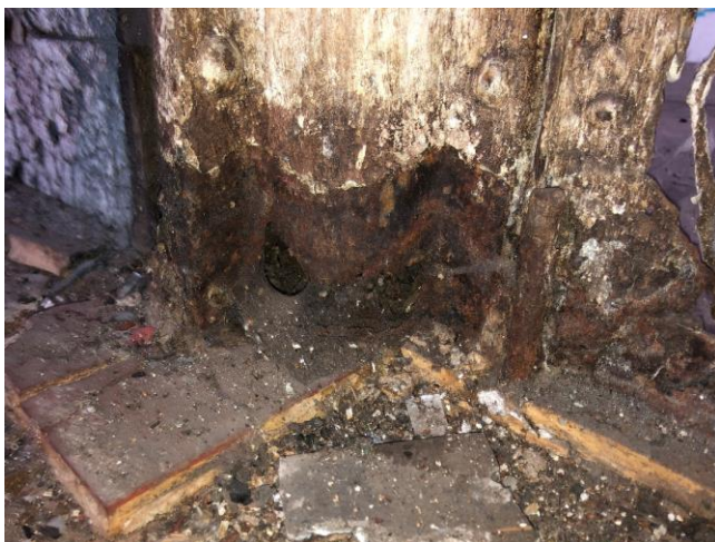
Foto Nr. 22 Kolonnu balsta mezgli virs grīdas caurkorodējuši.
