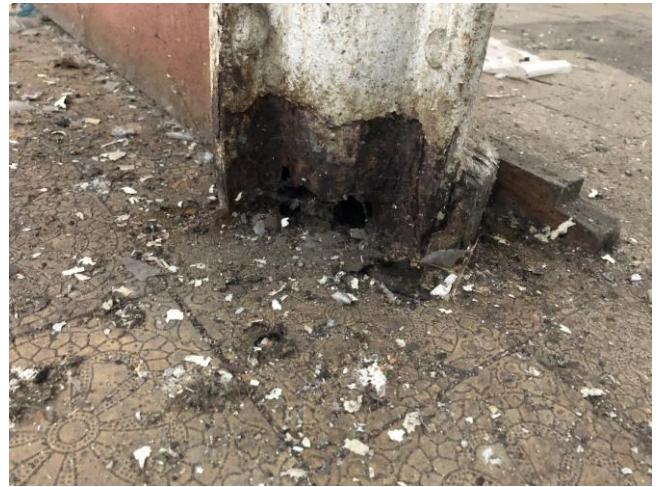
Foto Nr. 25 Kolonnu balsta mezgli virs grīdas caurkorodējuši.
