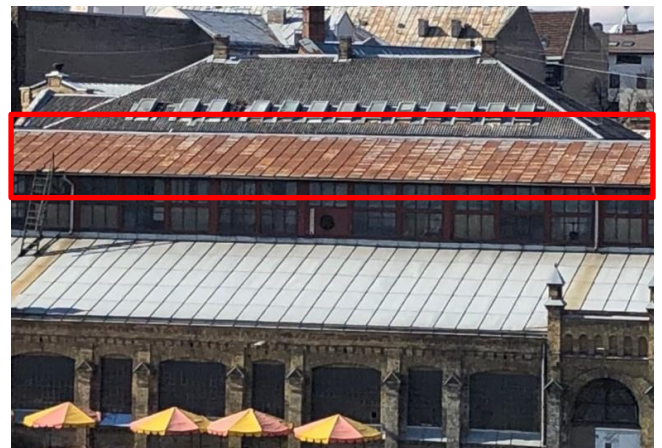
Foto Nr. 39 Virsgaismas zonas jumta segums korodējis.
