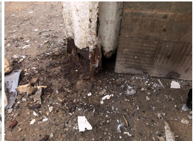
Foto Nr. 21 Kolonnu balsta mezgli virs grīdas caurkorodējuši.
